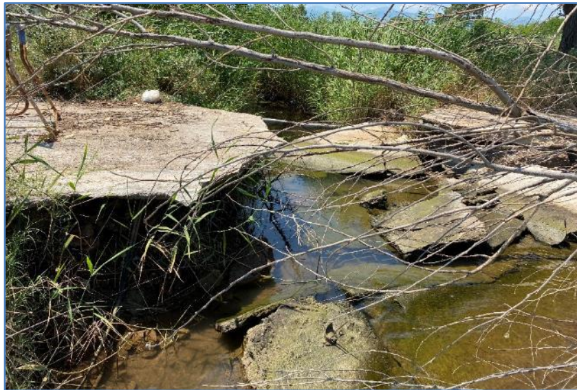
Φωτογραφία 3-18: Πλήρης κατάρρευση του γωνιακού τμήματος της υφιστάμενης κρηπίδωσης διατομής
